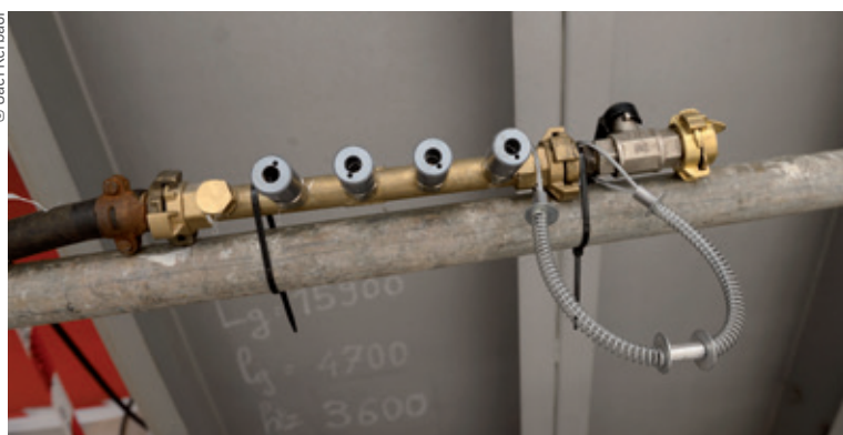
(Rampe pour alimentation en air comprimé)
